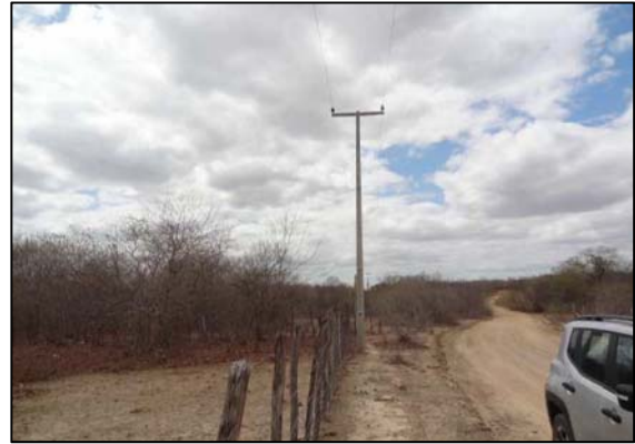
Foto 8: Rede de energia elétrica bifásica, que se desenvolve paralela a estrada vicinal cruzando a bacia hidráulica da Alternativa I.
